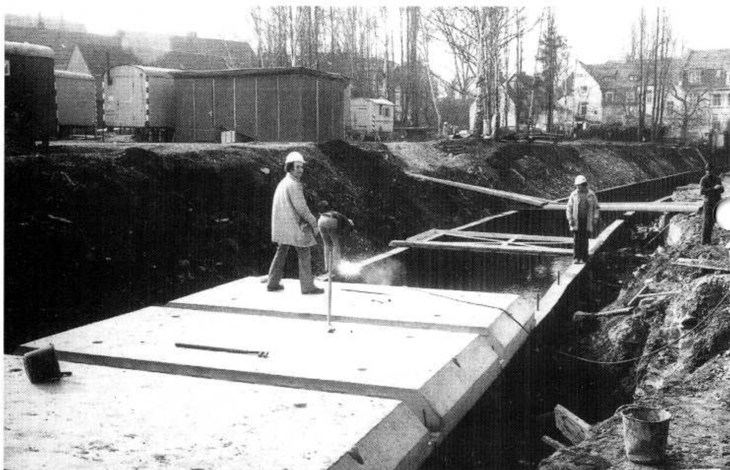
Schwere Betonplatten auf den immer fließenden Soestbach zwischen Hansastraße und Nötten-Brüder-Wallstraße. Foto: Stadtarchiv Soest, Neg.-Nr. A 1567/7
